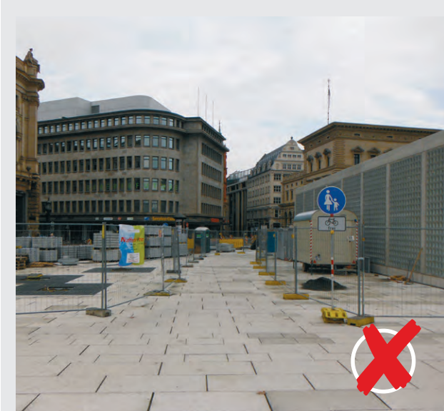
Bild 3 | Schlecht sichtbare Abspernung (z.B. ist im Dunkeln der Zaun nicht sichtbar und die Wegführung schlecht erkennbar).
