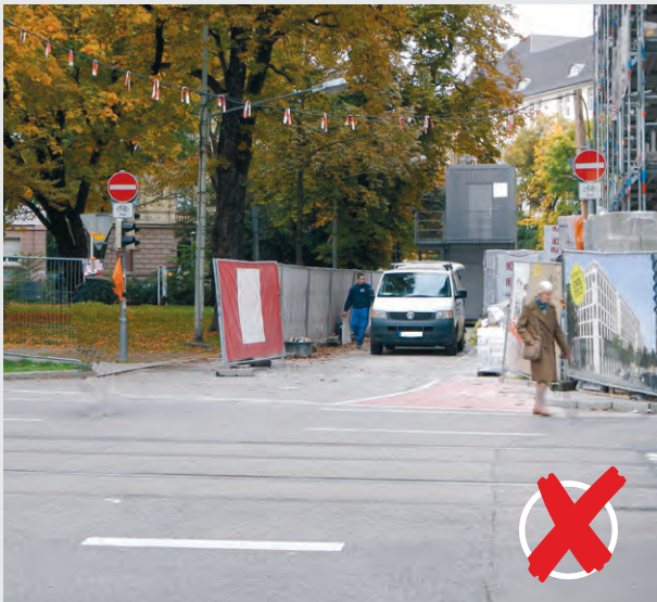
Bild 16 | Vollsperrung einer Straße: Nicht geltende Verkehrszeichen sind nicht abgedeckt.
