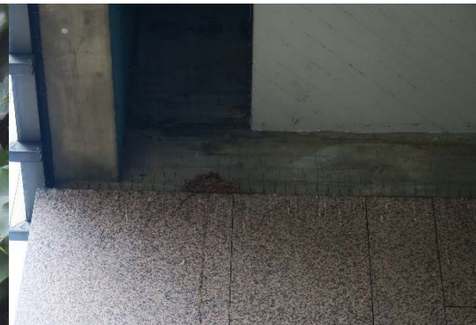
Abb. 7: Nest trotz Taubenabwehr an der Nordwest-Fassade
