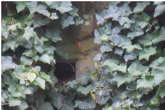
Abb. 6: Nest in Betonwand an der Nordseite
