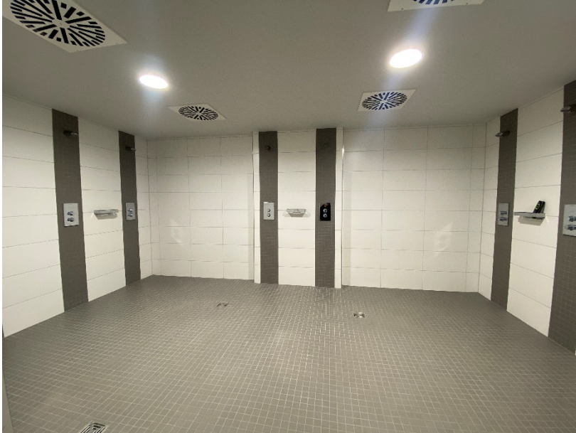
Neue Duschanlage gem. dem Standard entsprechend integrierter Lüftung
