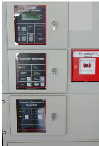
Beispielhafter Einbau einer Gebäudefunkanlage im FIZ
