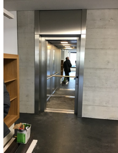
Aufzug Bau A
