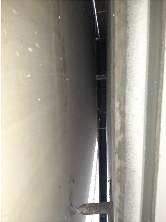
Abbildung 7: Spalten zwischen Fassade und Abdeckung
